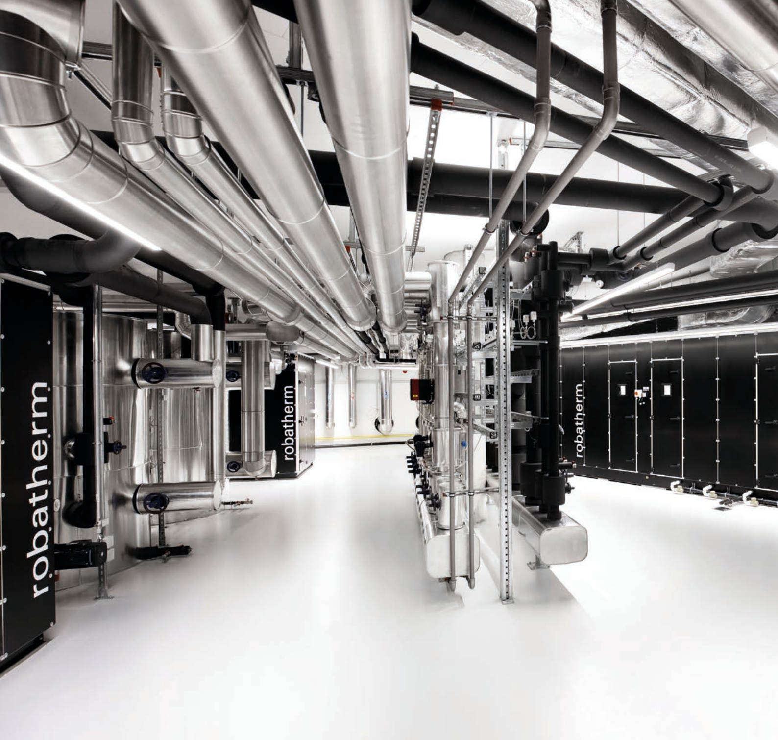
赏心悦目的机房: 配以黑色箱体的空气处理机组
